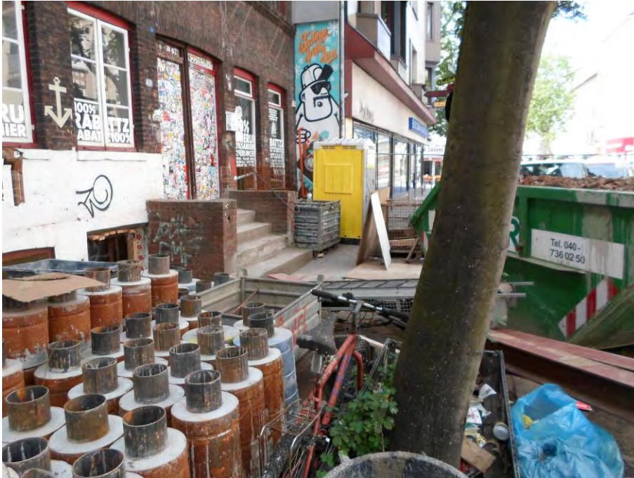
Während der Nachgründung in der Hein-Hoyer-Straße in Hamburg. Vor dem historischen Gebäude warten die Segmente der ERKA-Pfähle auf ihren Einsatz.
